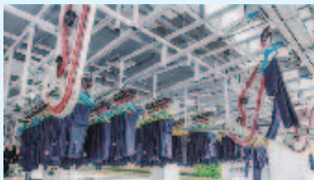
图3-9 智能化服装吊挂系统
