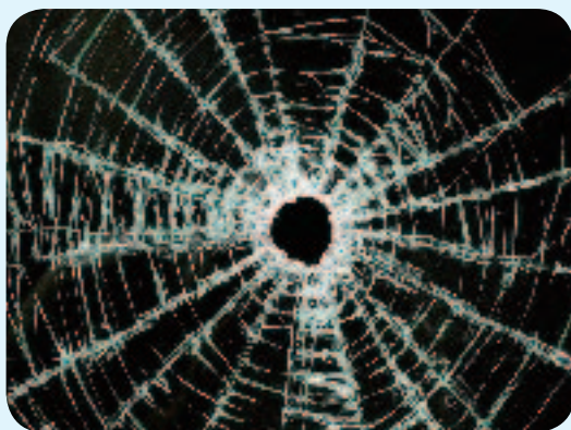
图1-18 爆裂的玻璃幕墙
