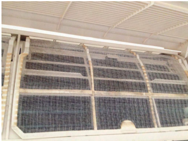
图5.4 空调过滤网上的灰尘
