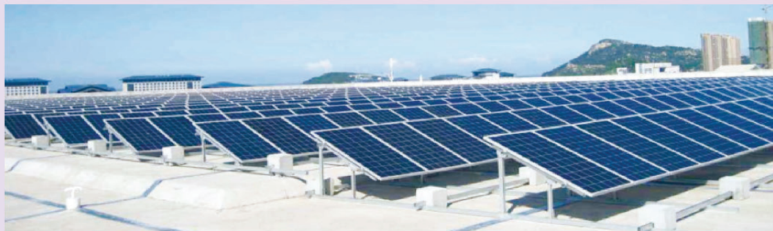
图 2-12 太阳能光伏电站
