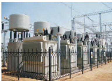
图 3-3-1 变电站大型变压器
