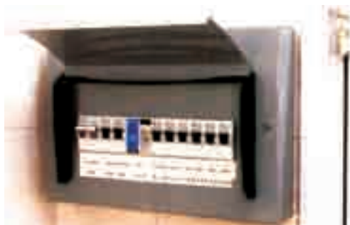
图1-64 安装在电路里的几个断路器
