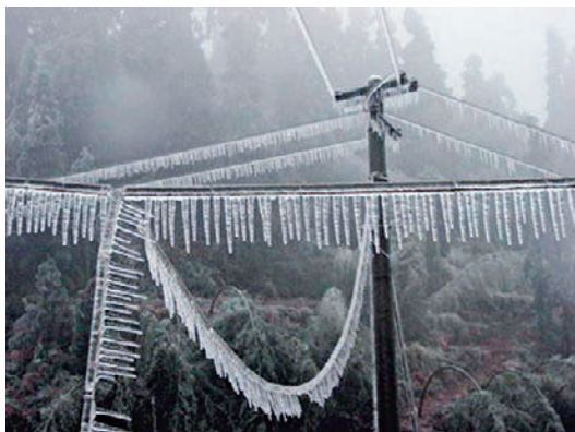
图 1.2.8 冻雨下落到输电线上形成冰柱
