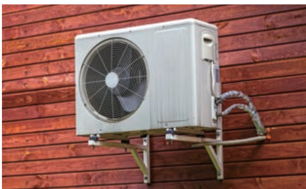
图1-7 空调的室外机支架
