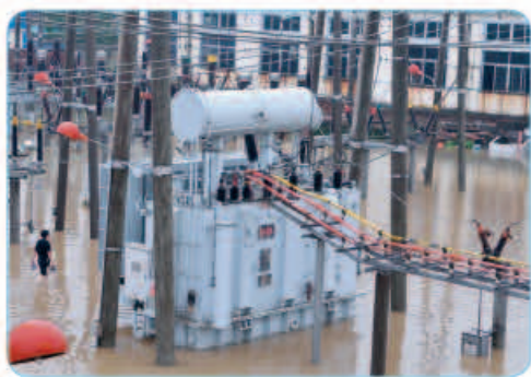
图4.1.1 电力设备被损坏
