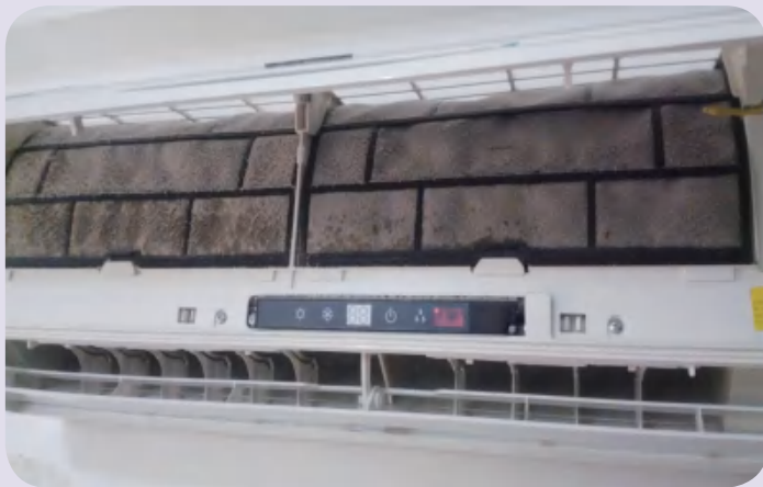
图4-14 空调进气栅过滤网上布满灰尘
