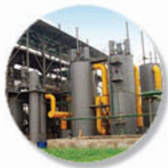
煤转化成煤气运出去
