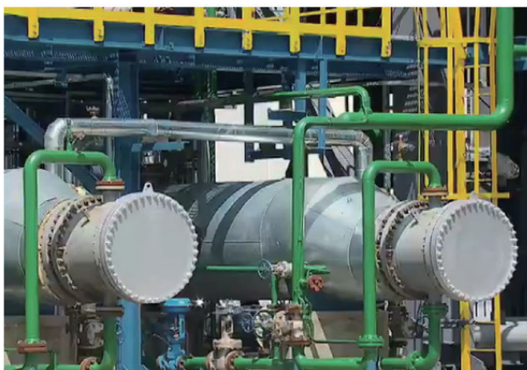
大庆120万吨乙烯生产装置
