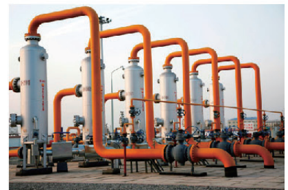
西气东输起始站塔里木油气田轮南站
