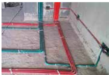
图 2-9-1 家居装修中，在地面和墙面铺设的电线可达上百米
