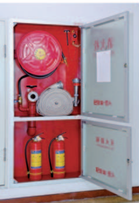
图7-10 建筑物内的消防设施
