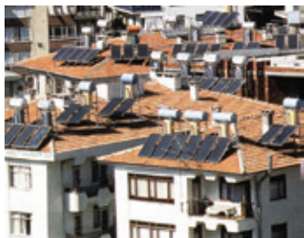
图 11-5-6 架设在屋顶的太阳能集热器
