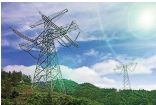
图4 特高压输电线
