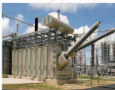
甲 变电站中的大型变压器
