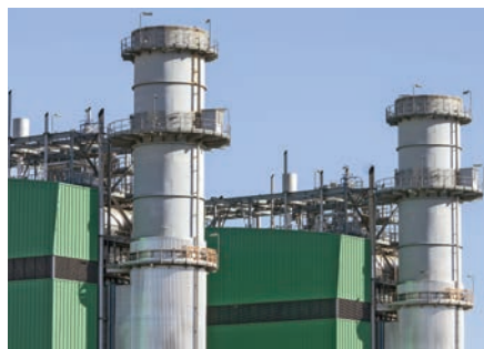
热电厂的蒸发塔
