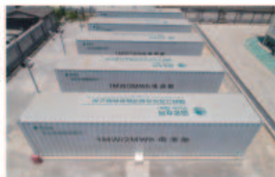
图4-5 锂离子电池储能电站
