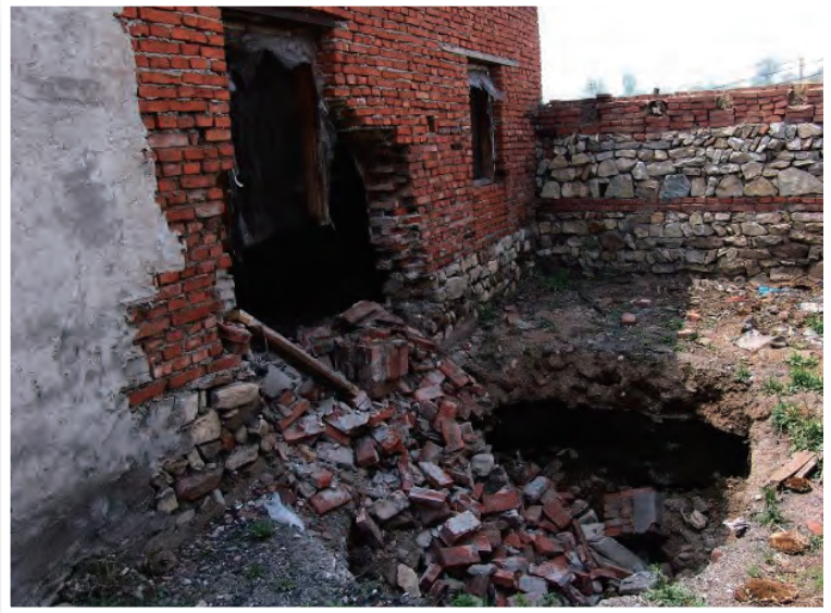
图 2-40 采煤沉陷区塌陷的房屋
