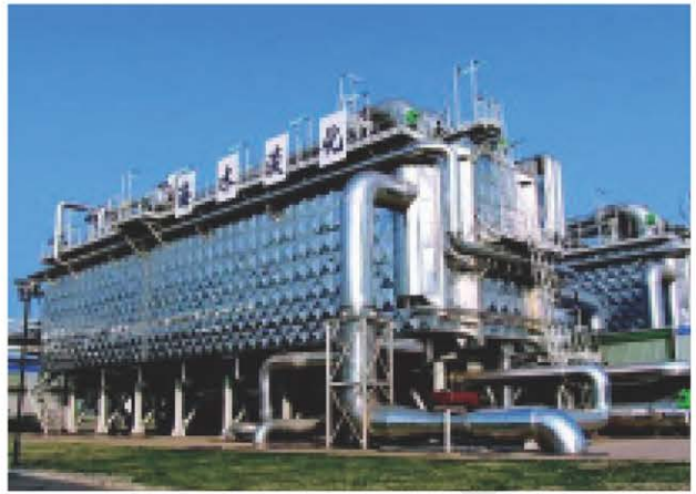
首钢京唐海水淡化工程
