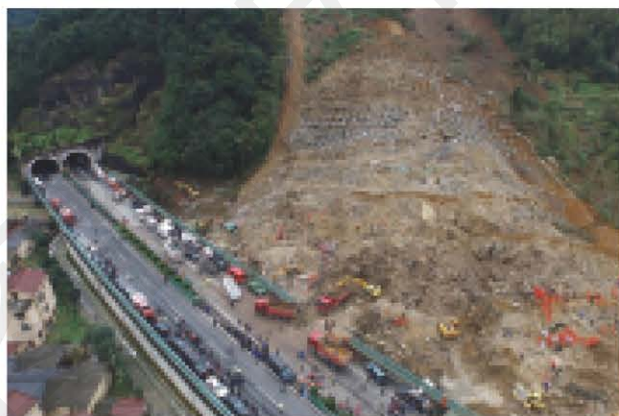
图 3-1-5 2015 年 11 月浙江丽水山体滑坡现场
