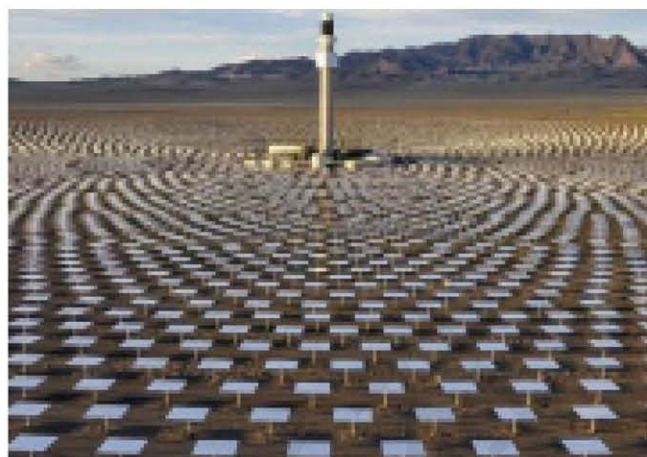
太阳能光热电站
