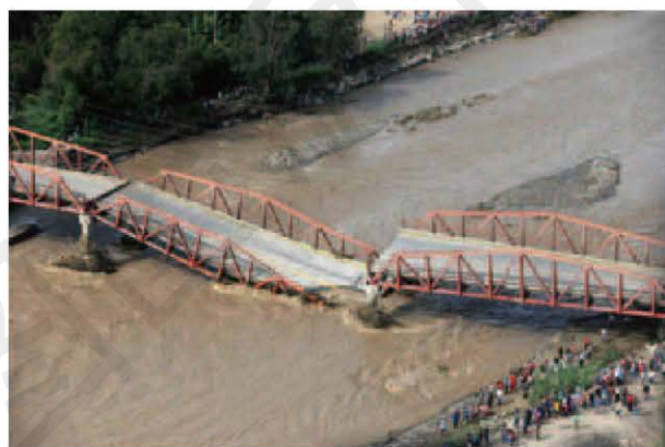
图 4-3-8 2017 年秘鲁沿海地区暴雨引发洪水灾害使多座桥梁断裂
