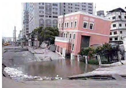
图 4-47 上海修建轨道交通时发生的地面沉降
