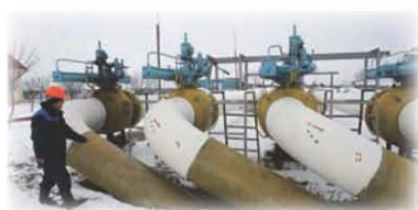
天然气运输管道
