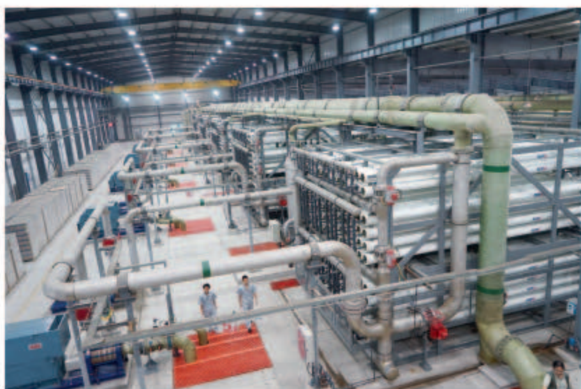
图 3.14 河北唐山曹妃甸的海水淡化车间
