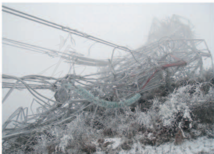
图6.8 寒潮破坏输电线路
