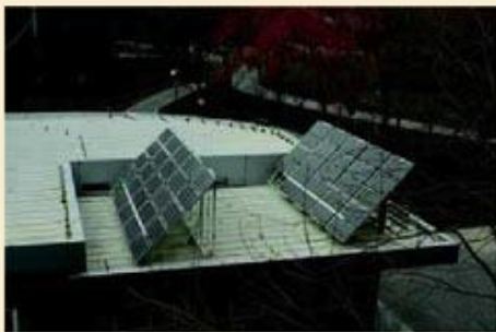
图4.5-1 北京万寿公园的光伏电站
